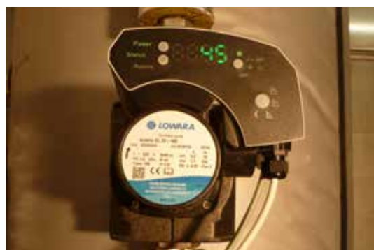
Die eingesetzten Lowara ecocirc XL zeichnen sich neben der Energieeffizienz durch eine exakte Drehzahlregelung aus
